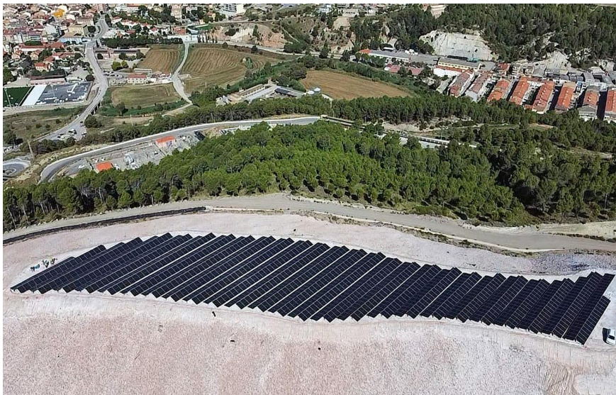
Vista aèria del parc solar del dipòsit salí vell, amb les plaques instal·lades. El projecte convertirà Súria en un municipi pioner en l'àmbit de les energies renovables.
