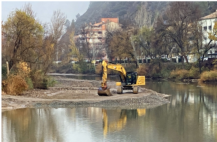
Maquinària pesada a la vora del riu, durant l'actuació realitzada recentment L'objectiu dels treballs era retirar fangs i sediments com a mesura de precaució.
