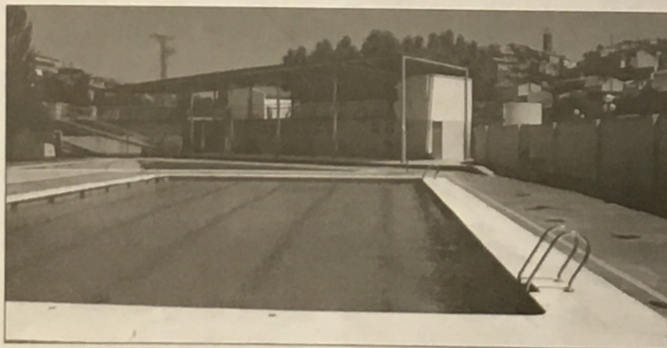
S'han reparat a fons els problemes d'humitat i degoters dels vestidors de la piscina municipal.
