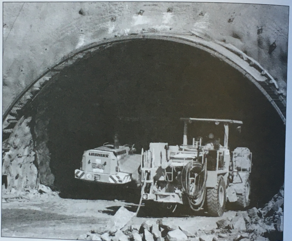
El túnel de la Torre, a les proximitats de Salipota, ja comença a veure's.
