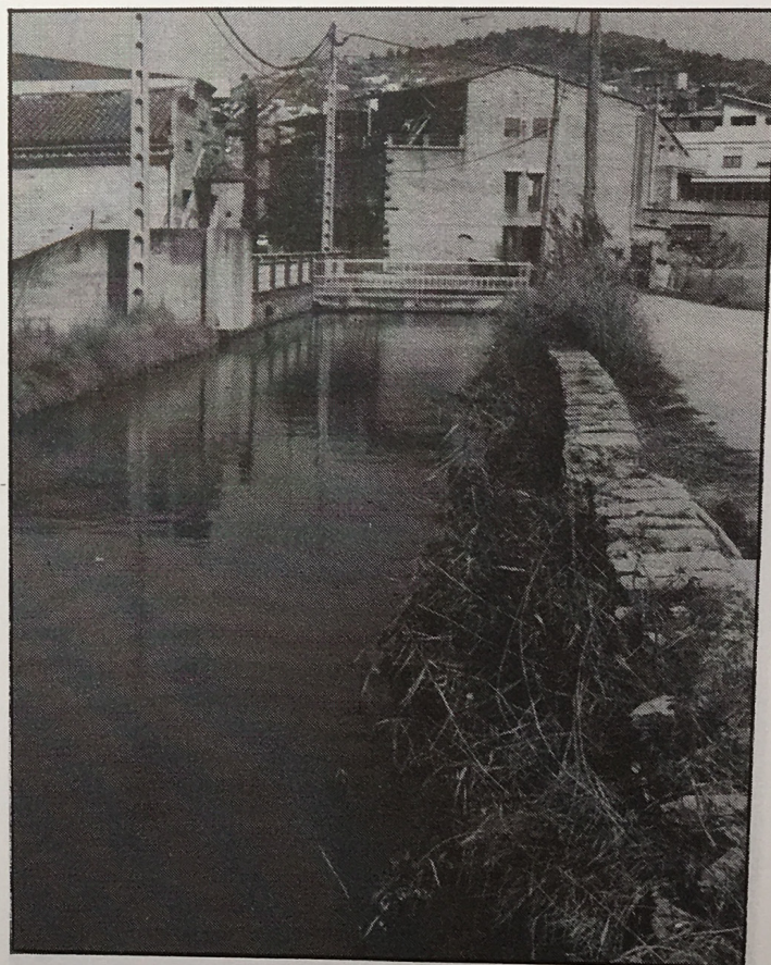
El canal que travessa el carrer d'Ignasi Abadal es troba en molt mal estat de conservació.
